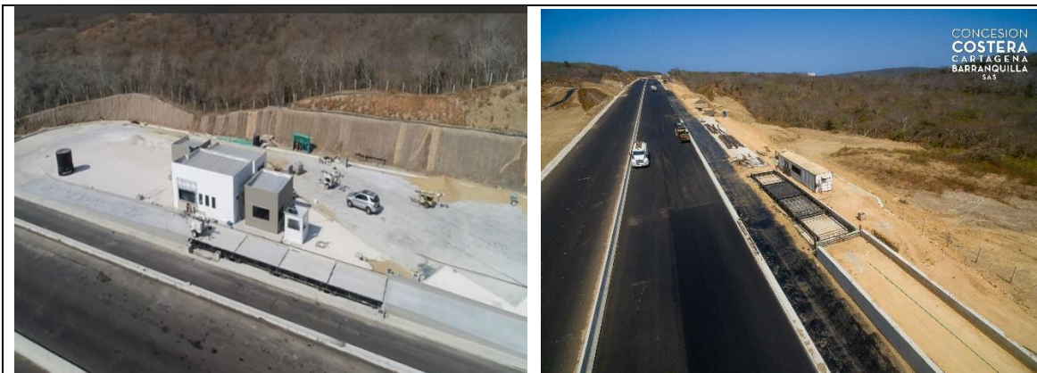
Estación de Pesaje – PR25+800 CI
